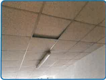
PRLV n° 1 sur Faux plafond Plaques polystyrènes
