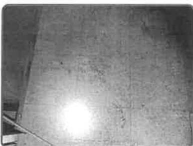
PRLV n° 1 sur Sol Dalles de sol
