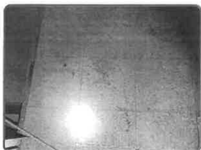
PRLV n° 1 sur Sol Dalles de sol
