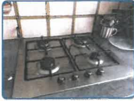
Appareil n°1 (Table de cuisson) sur Installation n°1 (dans Appartement Bâme étage Cuisine)
